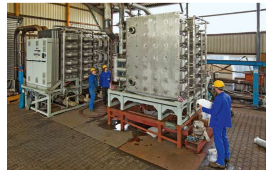
Schiffstauglich: Die thermische Energie wird zuerst für die Absorptionskälteanlage und später für die Produktion von Frischwasser genutzt.
