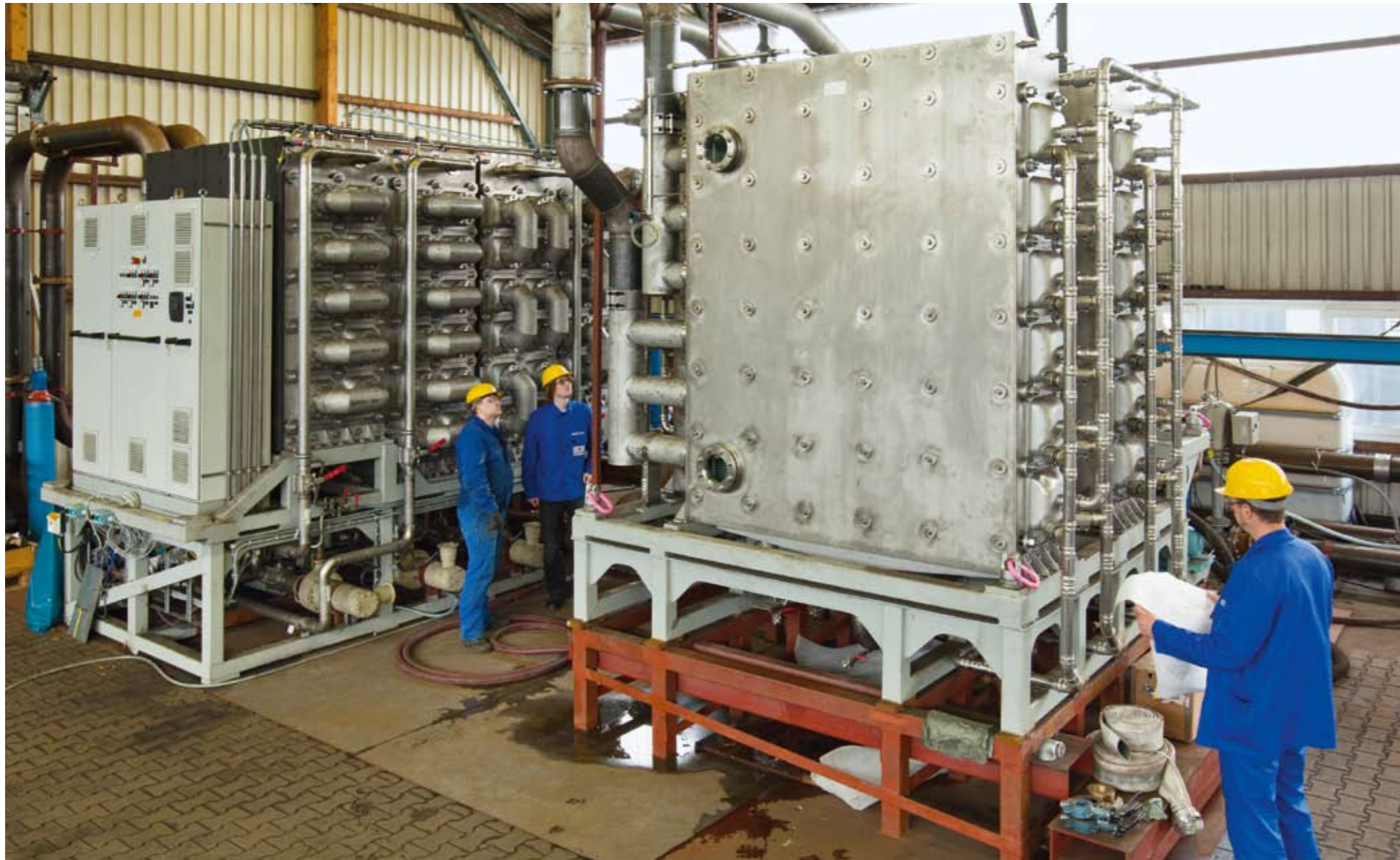
Effizienz: Absorptionskälteanlage zur optimalen Nutzung der thermischen Energie
